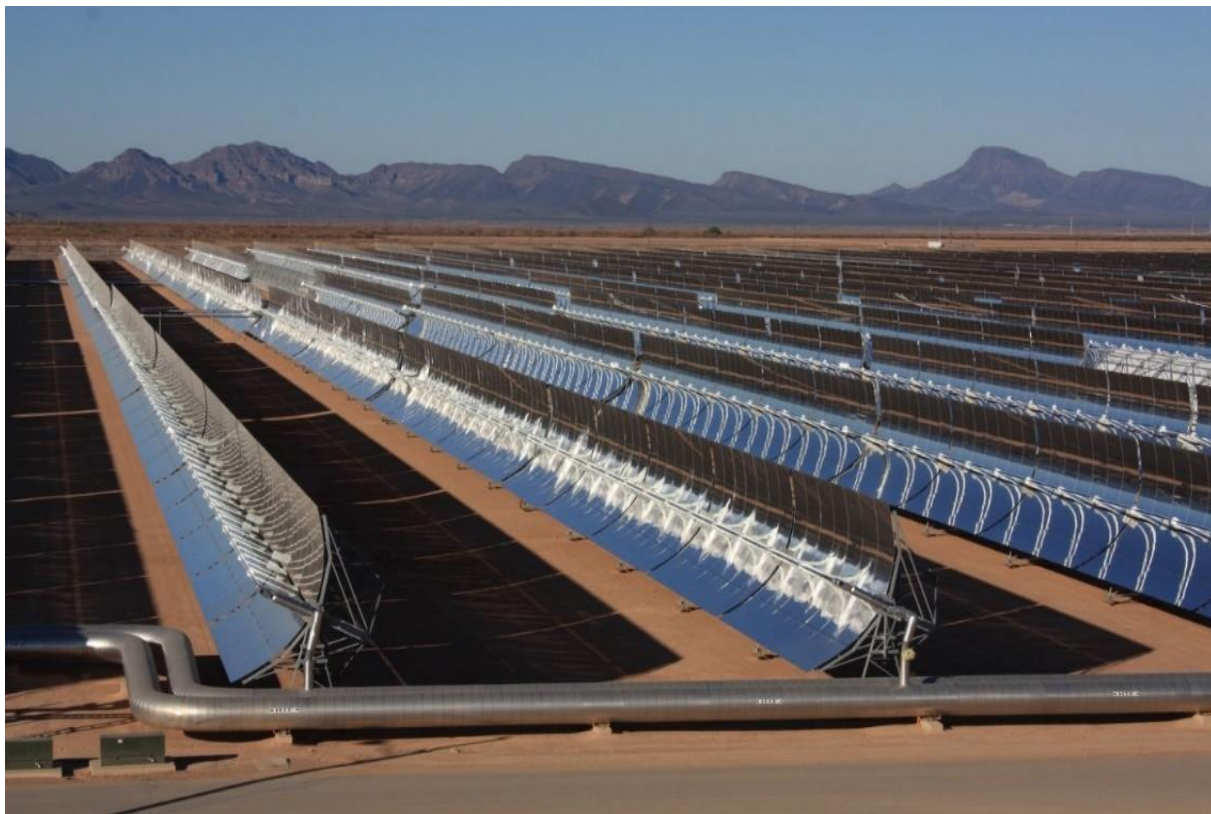
Figura 15. Planta Termo Solar Solana
